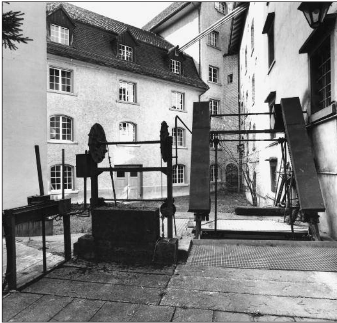
Mühlenkanal mit Kanal-Laubrechenanlage. (Bild KDP)
