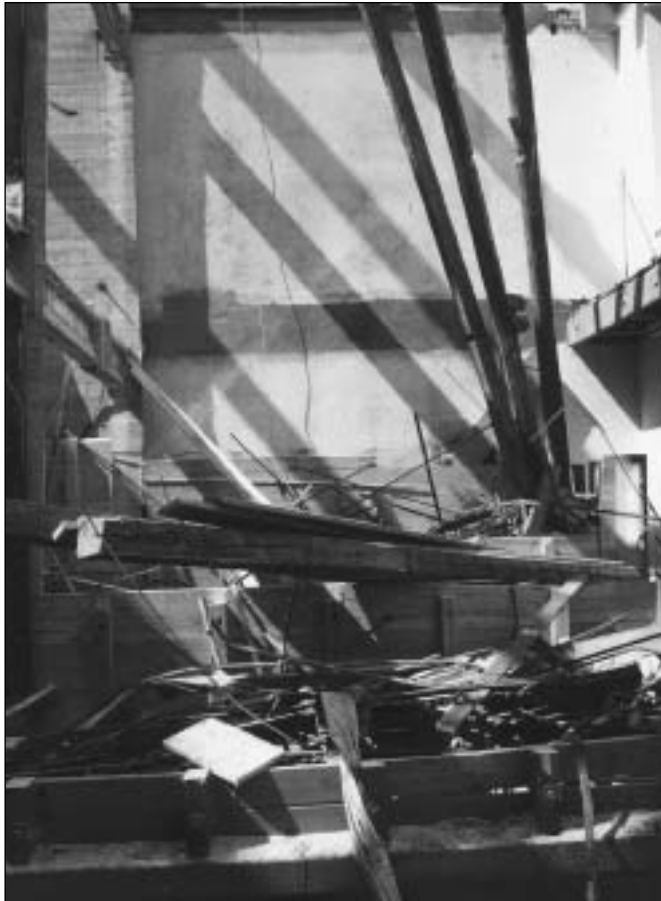
Die Stilllegungs- und Abbruchwelle geht weiter: Abbruch der Mühle Zürich Altstetten 1999 inklusive Transmissions- und Maschinenteilen von 1898.
