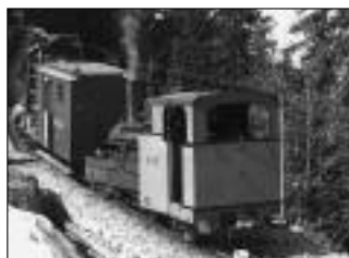
Mit Dampflok 5 wird im Frühling die Fahrleitung zur Schynigen Platte montiert, HB 1992
